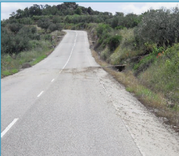
Figura 86. Arcén sucio, con arrastres.
