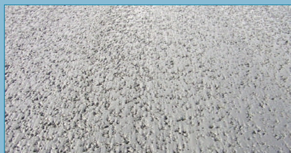
Figura 78. Depósito de caucho en toma de tierra de los aviones en pista aeropuerto.
