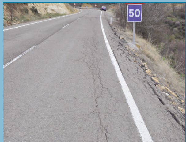
Figura 89. Arcén agrietado por asiento de terraplén.
