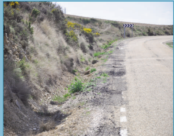
Figura 84. Arcén en mal estado no utilizable.
