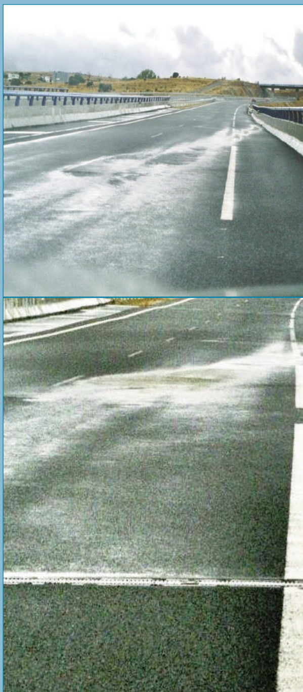
Figura 72. Formación de charcos de agua localizados en un pavimento drenante.
