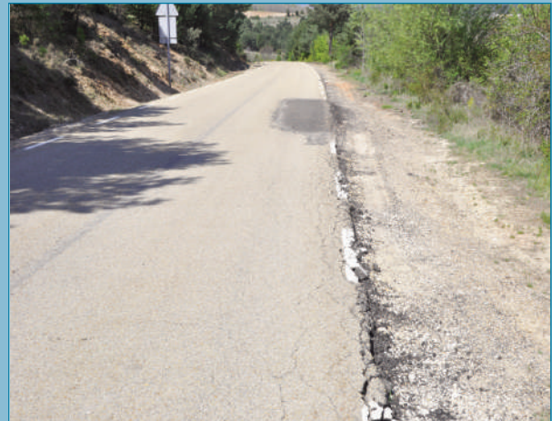
Figura 88. Arcén inutilizado por mordiente en mal estado.
