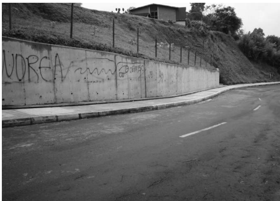
Muro de contención, parcelación El Monte, vereda Las Palmas, Corregimiento Santa Elena.
