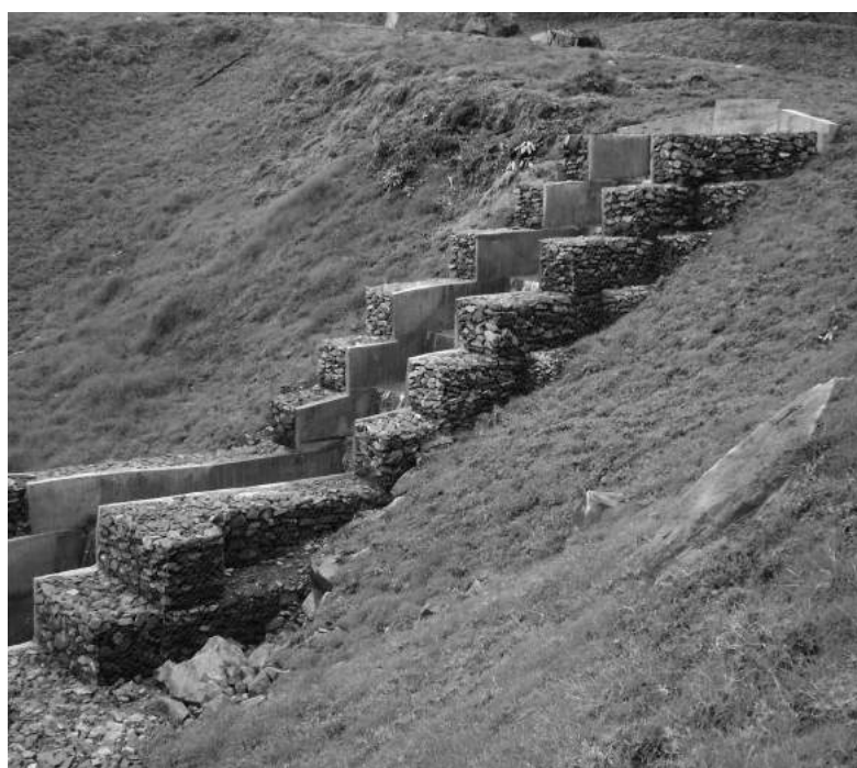
Canal en gavión, Vereda Montañita, Corregimiento San Antonio de Prado.
