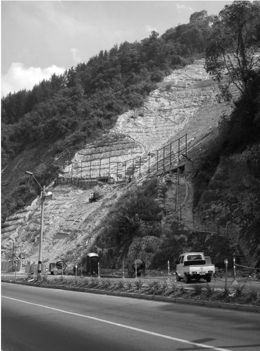
Estabilización Vía Las Palmas, Municipio de Envigado.
