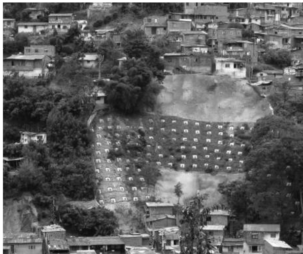
Obra de estabilización con anclajes, Comuna 2, Santa Cruz, sector Santa Lucía - Las Estancias.
