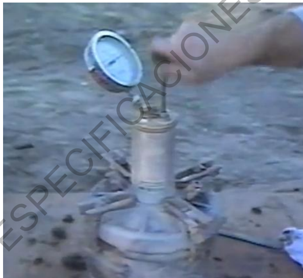
Figura 406 - 8. Bombeo de aire en la cámara del medidor tipo B
