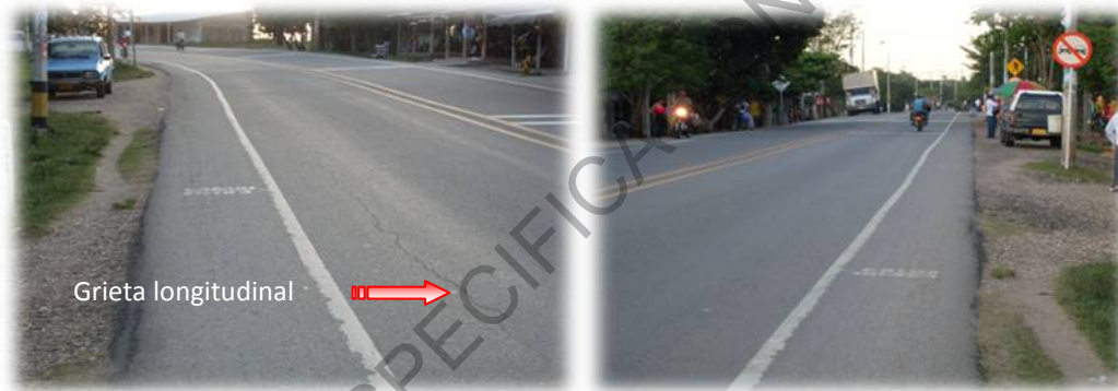
Figura 813 - 2. Incidencia de los rayos solares en la observación visual de las grietas en un pavimento flexible
