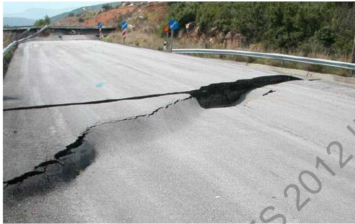
Figura 813 - 3. Falla de un terraplén bajo un pavimento
