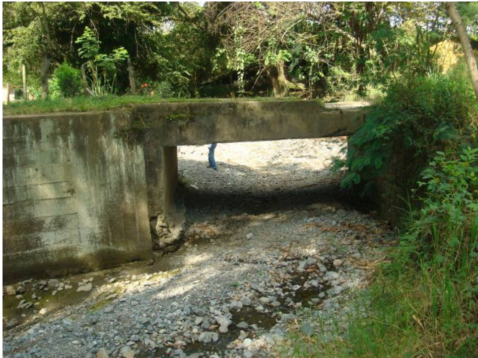
Figura 6.4. - Pontón sobre la quebrada Vanegas, localizado en la abscisa k1+230 de la vía que conduce del Municipio de Ginebra al Corregimiento de la Floresta en el Departamento del Valle.
